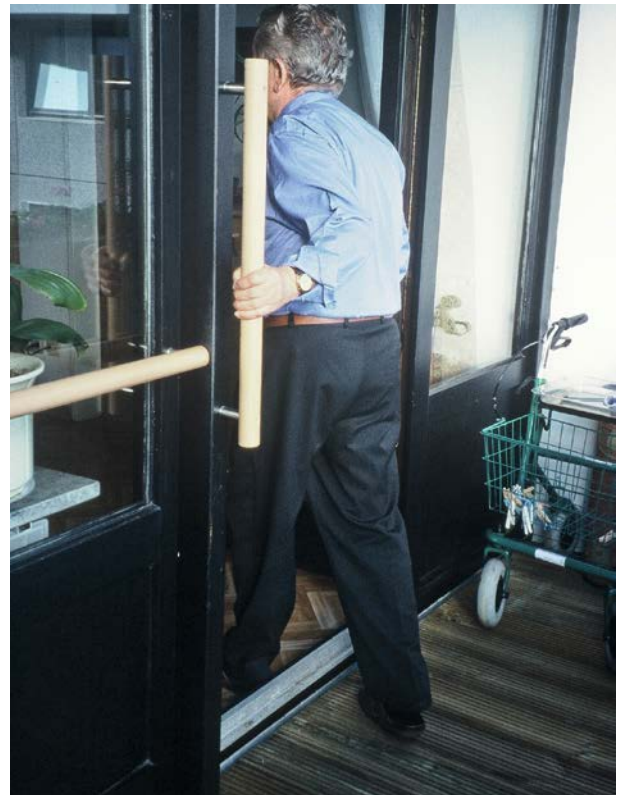
Die Stufe zum Balkon verschwindet durch das nachträgliche Anheben des Balkonfußbodens.
