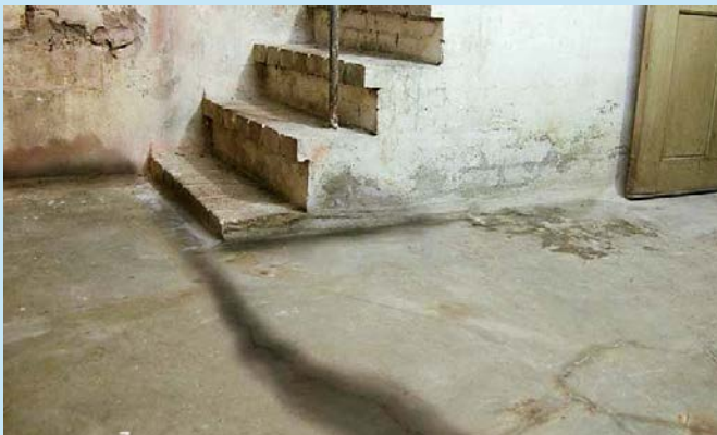
Abbildung 17: Nässe spur im Keller entlang einer defekten Grundleitung
